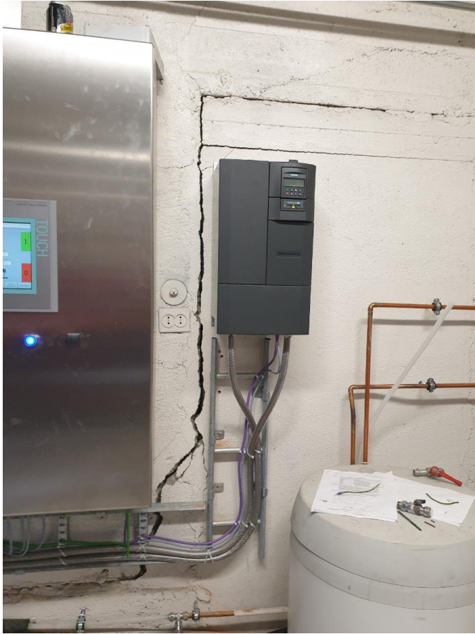
Setningsskader i Vaskerilab i Ny-Ålesund, før bygningen ble refundamentert. Foto: Kings Bay AS.
