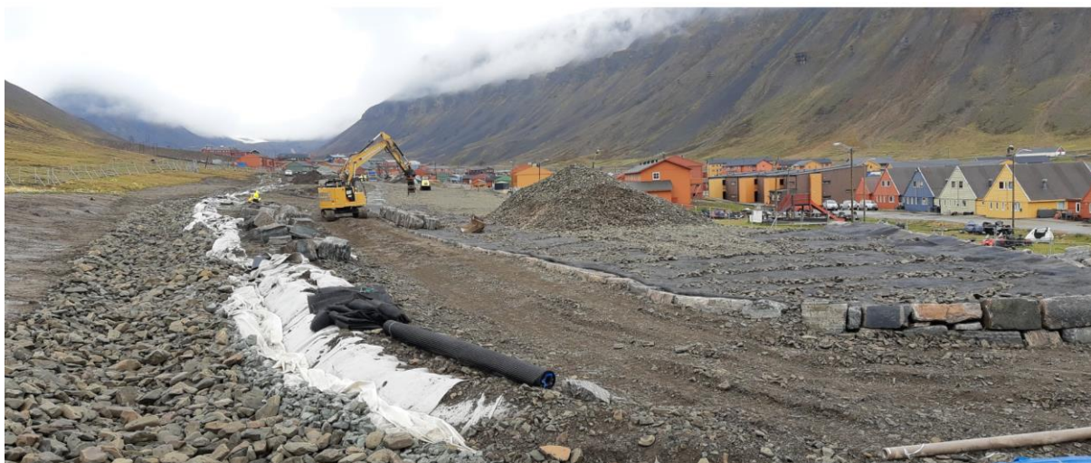
Området i Longyearbyen som ble rammet av skred, slik det så ut i august 2021. Foto: Riksrevisjonen 2021.
