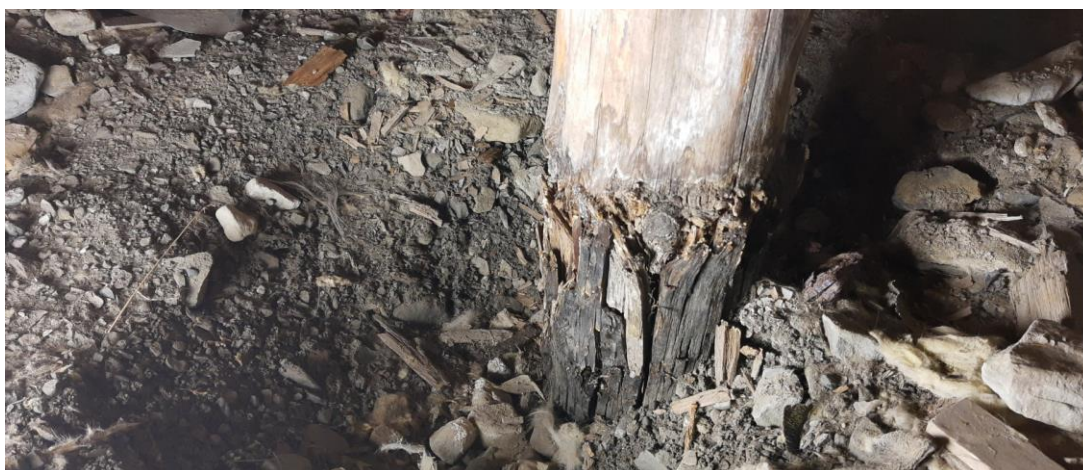
Råtten trepæl på en av brakkene i Nybyen. Foto: Riksrevisjonen 2021.
