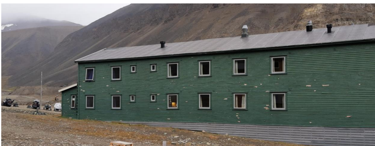
Maling som flasser av i store flak fra ytterpanelet på brakke i Nybyen. Foto: Riksrevisjonen 2021.
