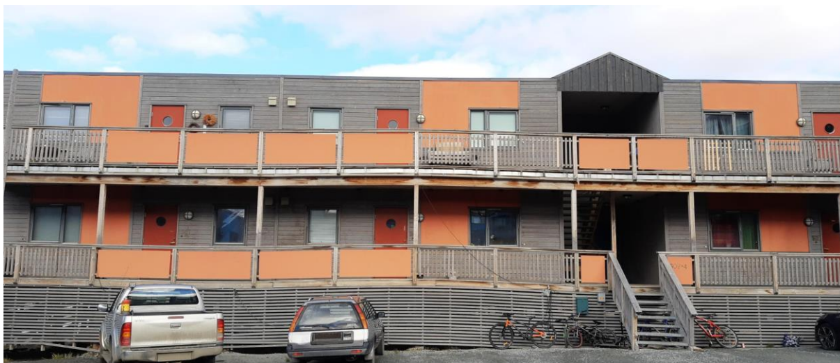
Synlige setningsskader på SNBs boliger på Elvesletta nord. Foto Riksrevisjonen 2021.
