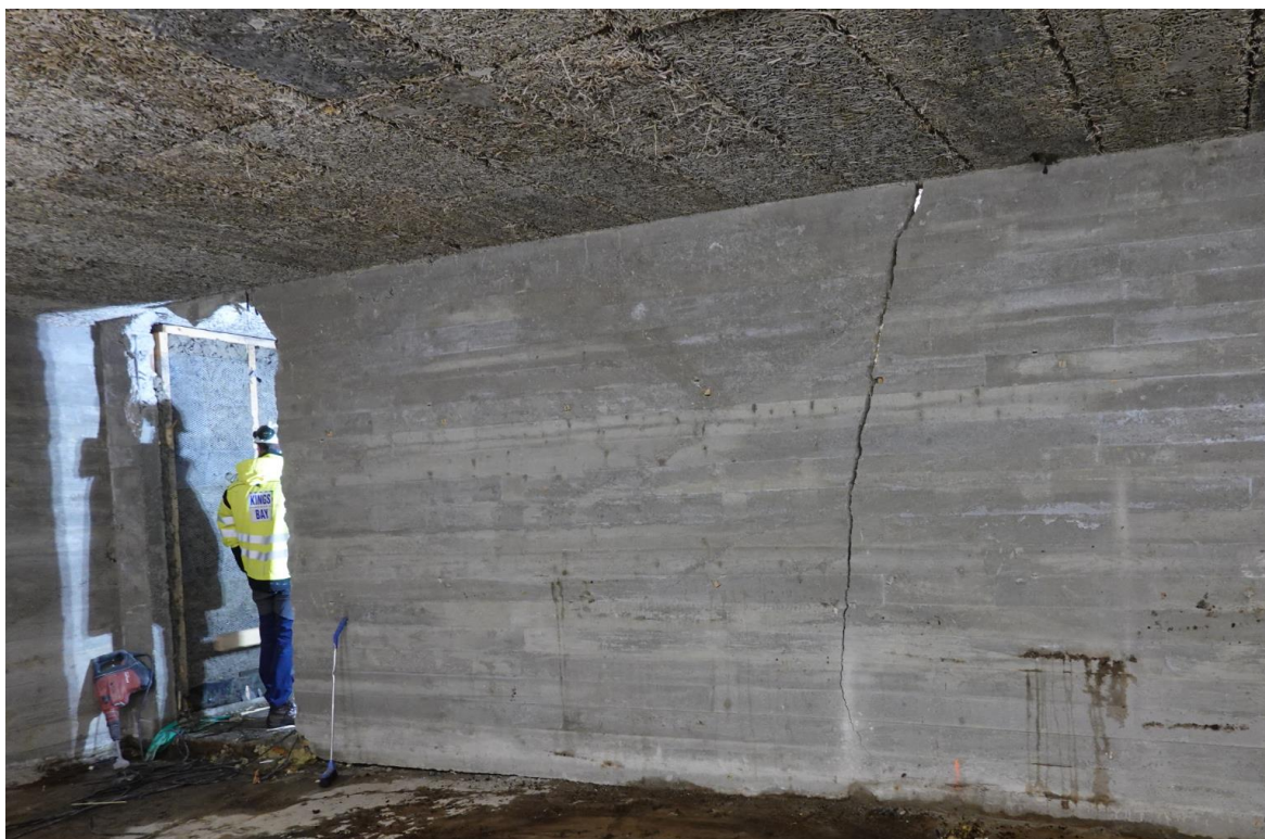
Setningskader på Servicebygget i Ny-Ålesund, før det ble refundamentert. Foto: Kings Bay AS.
