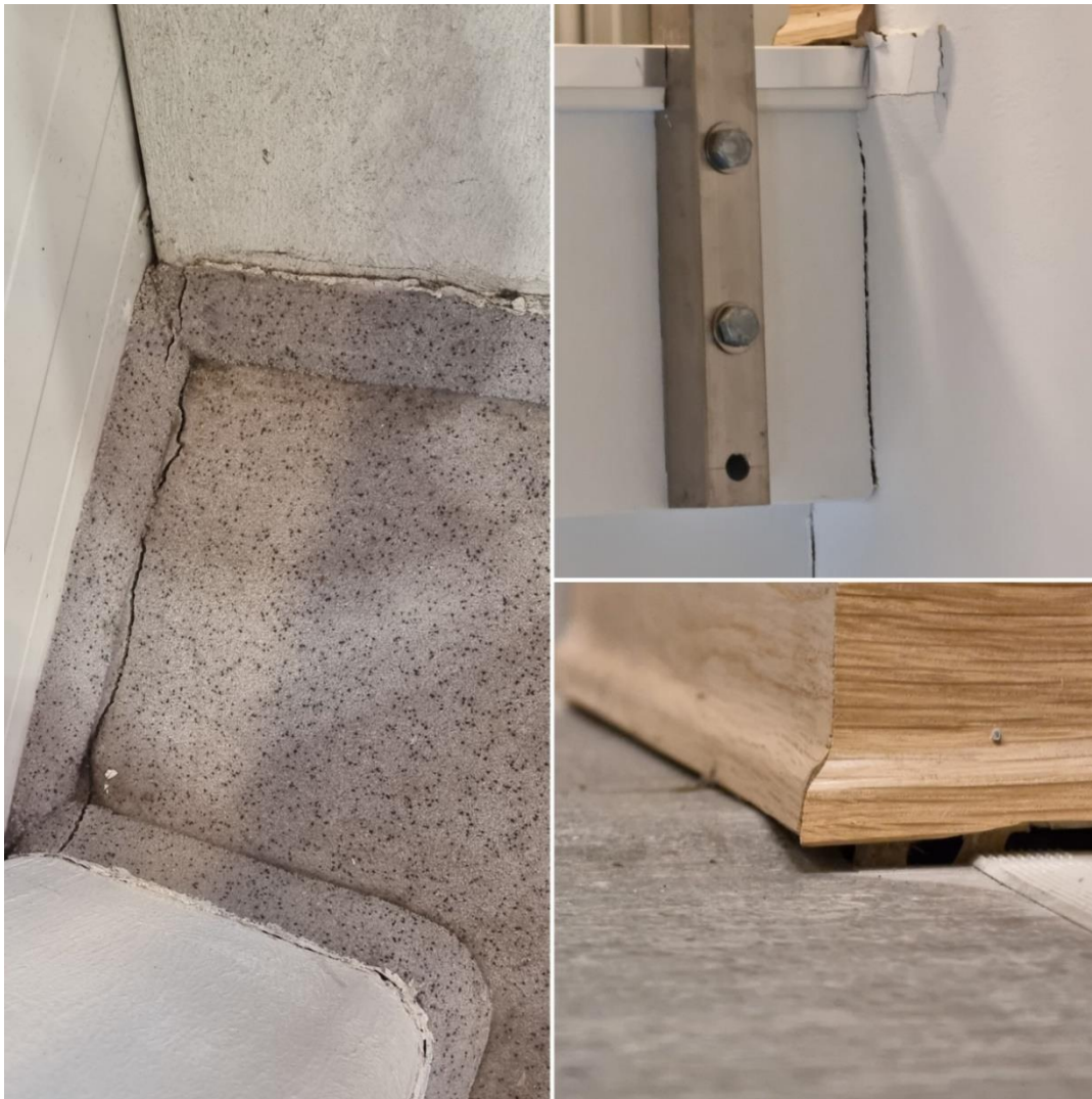
Bildet til venstre: Sprekk rundt gulvsøyler i helikopterhangar fra 2014 (bygg 1). Bildet øverst til høyre: Sprekk i en vegg i bygg 5. Bildet nederst til høyre: Sprekk langs gulvlist i bygg 5. Fotos: Riksrevisjonen 2021.
