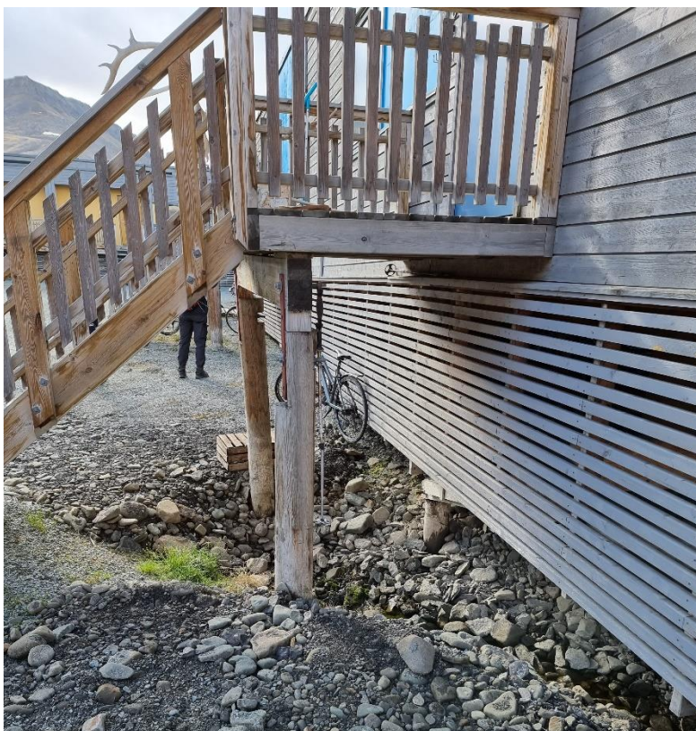
Store bevegelser i grunnen gjør at fundamenteringen til SNBs boliger på Elvesletta nord flere steder har ført til svært skjeve bygninger. Foto: Riksrevisjonen 2021.
