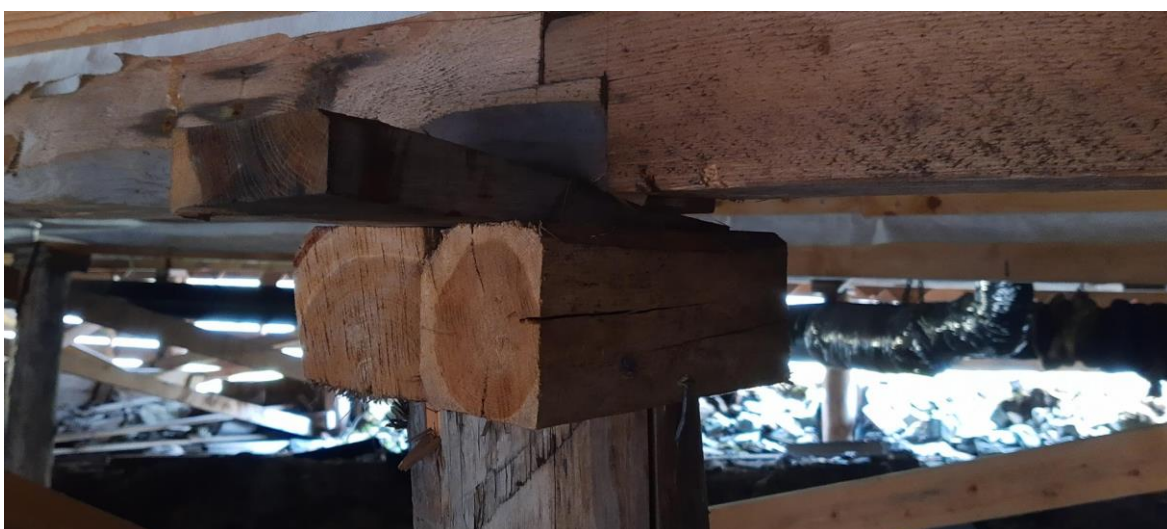
Klosser satt inn over trepæl på en av brakkene i Nybyen. Foto: Riksrevisjonen 2021.
