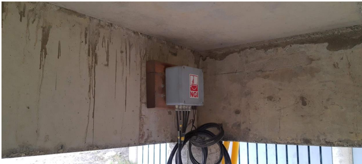
Termistor plassert under Longyearbyen sykehus. Foto: Riksrevisjonen 2021.
