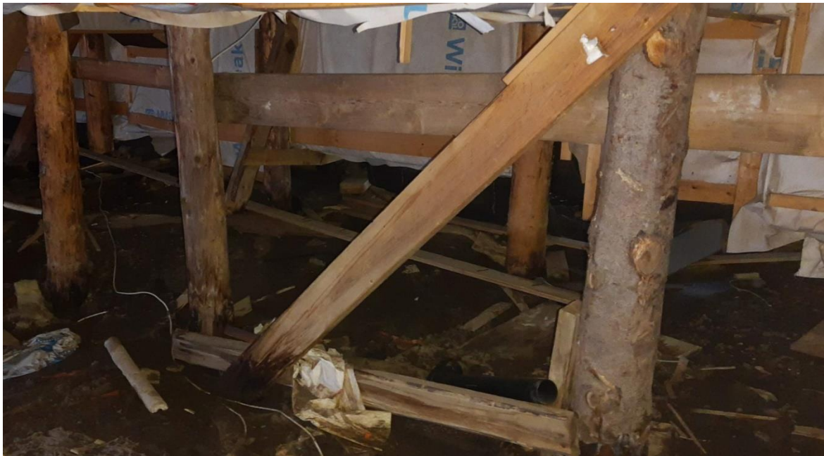
Fundamenteringen til Coal Miners' Cabins brakke 1. Pælene er angrepet av brunr te grunnet mer fukt og permafrost som tiner. Foto: Riksrevisjonen 2021.
