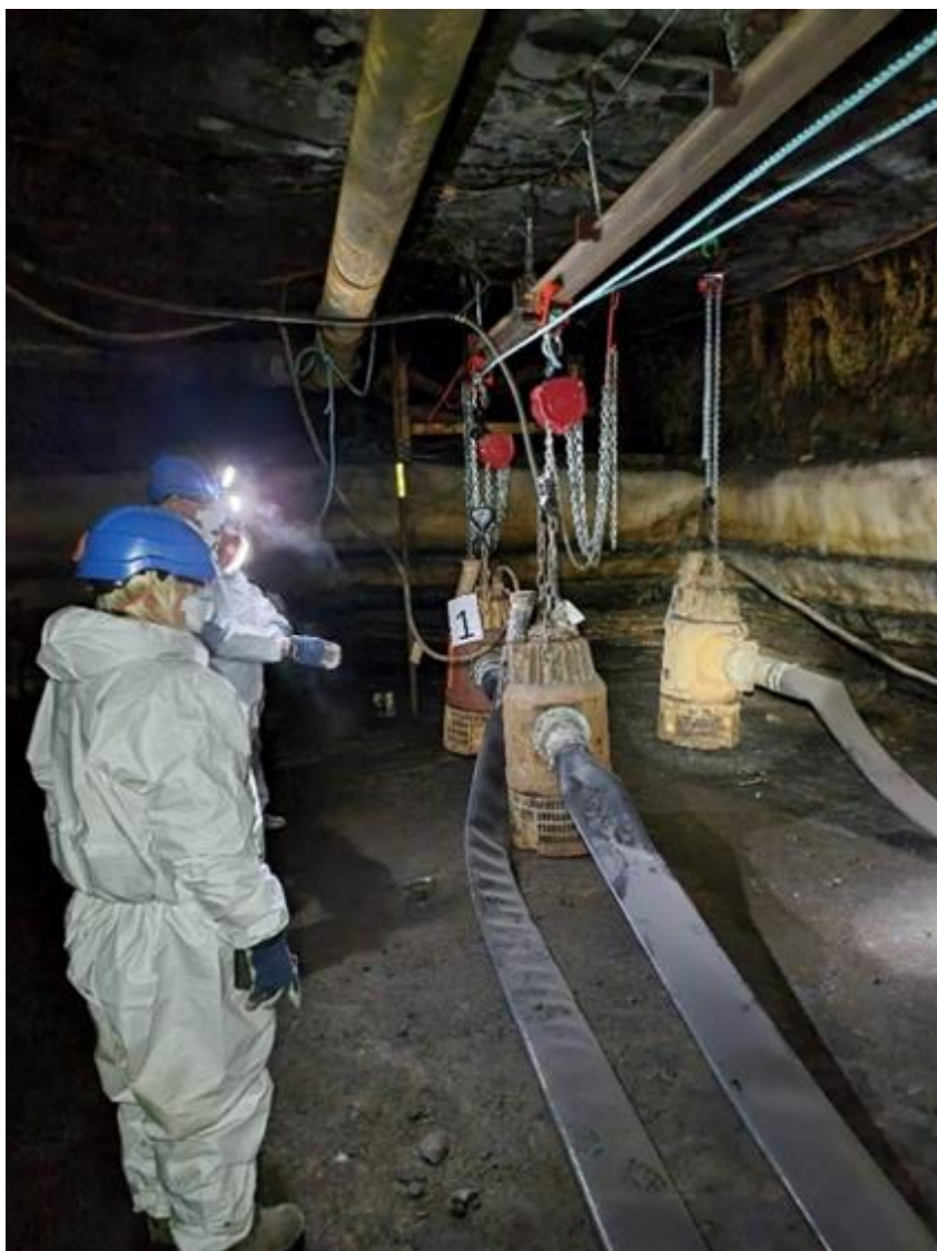
Nye pumper som er installert i Gruve 7 i etterkant av vanninntrengingen. Foto: Riksrevisjonen 2021.
