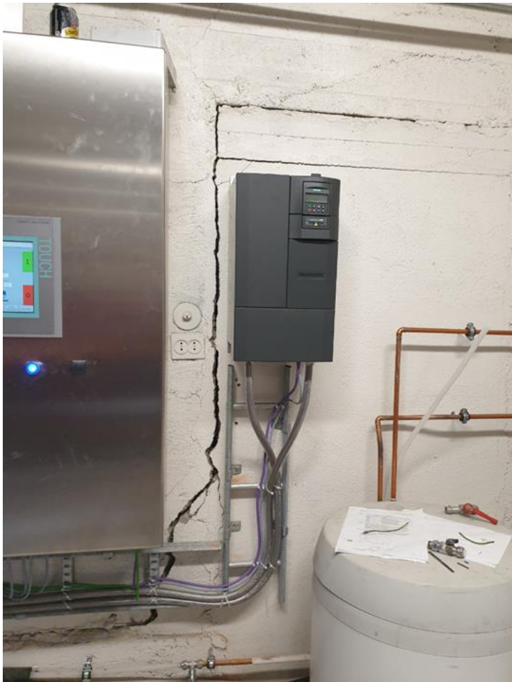
Setningsskader i Vaskerilab i Ny-Ålesund før bygningen ble refundamentert. Foto: Kings Bay AS.
